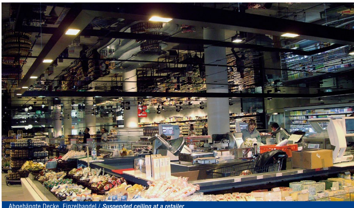
Abgehängte Decke, Einzelhandel / Suspended ceiling at a retailer
